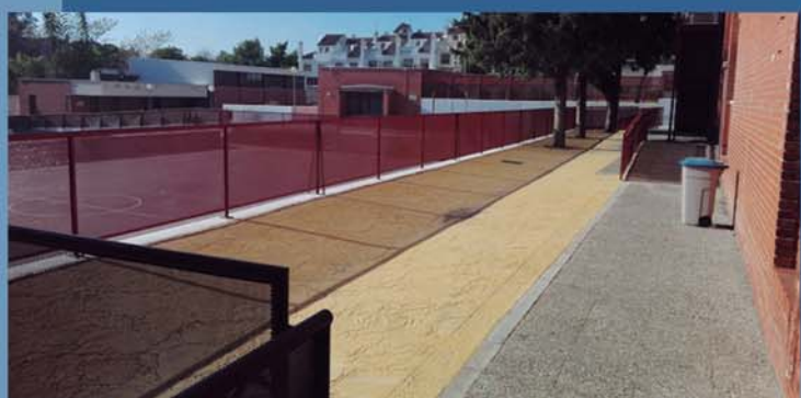
Nuevo pavimento de hormigón impreso, vallado del graderío y salida de emergencia.
